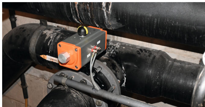
Neue Absperrklappe 565 in der Filteranlage
